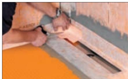
1 Schlüter-KERDI Manschette mit Schlüter-KERDI-COLL-L dicht verkleben. Die im Lieferumfang enthaltene Schlüter-KERECK Innenecke zuschneiden ...
